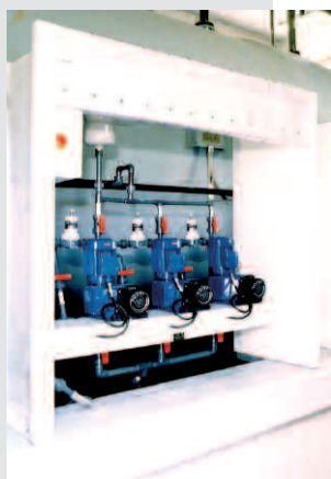
Bombas dosificadoras integradas en un conjunto de dosificación para el tratamiento del agua
